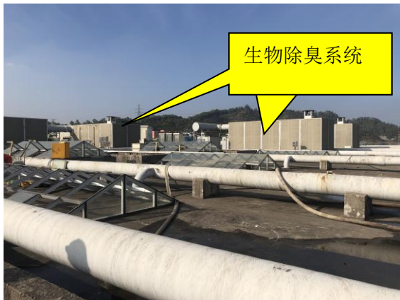
二期AAO生化池及除臭系统
