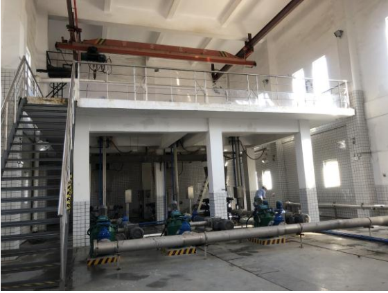
污泥浓缩脱水间
