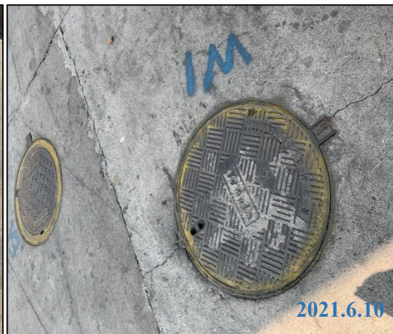
项目所在园区污水井
