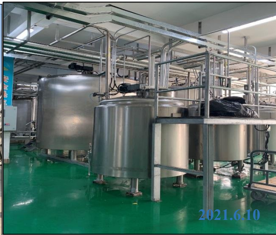
项目车间状况
