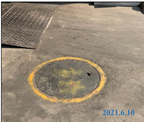
项目所在园区雨水井
